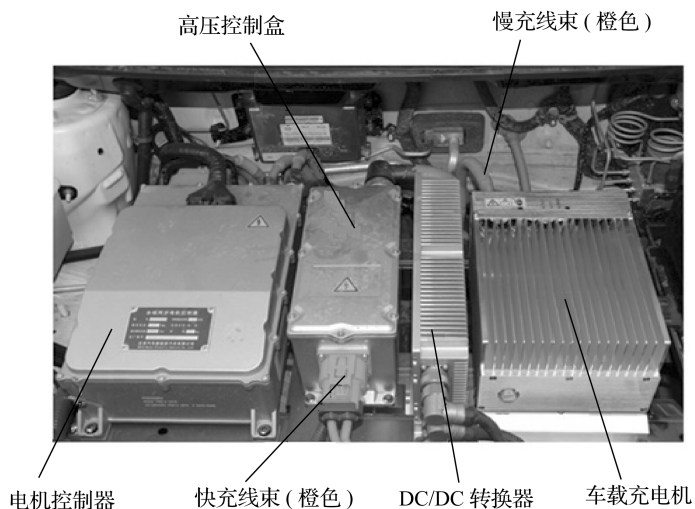
图 1-1-6 北汽新能源纯电动汽车高压电路前舱
